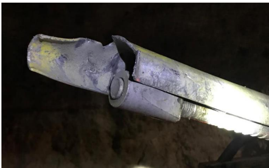
Imagen N°6: MC_300RP-EC576. Error de emboquille en instalación de perno
