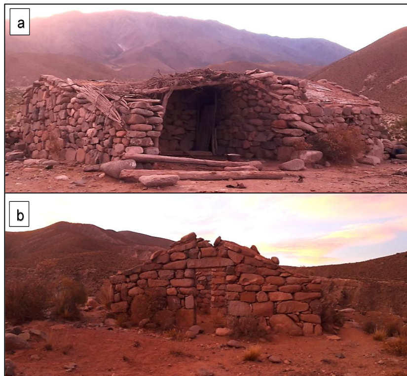
Foto N° 3 - (a) y (b) Puestos abandonados y en deterioro localizados al costado a la huella que permite el acceso a la zona de la Toma de agua de los ríos Ampato y Las Lechuza, hacia el oeste de la localidad de Palo Blanco.
