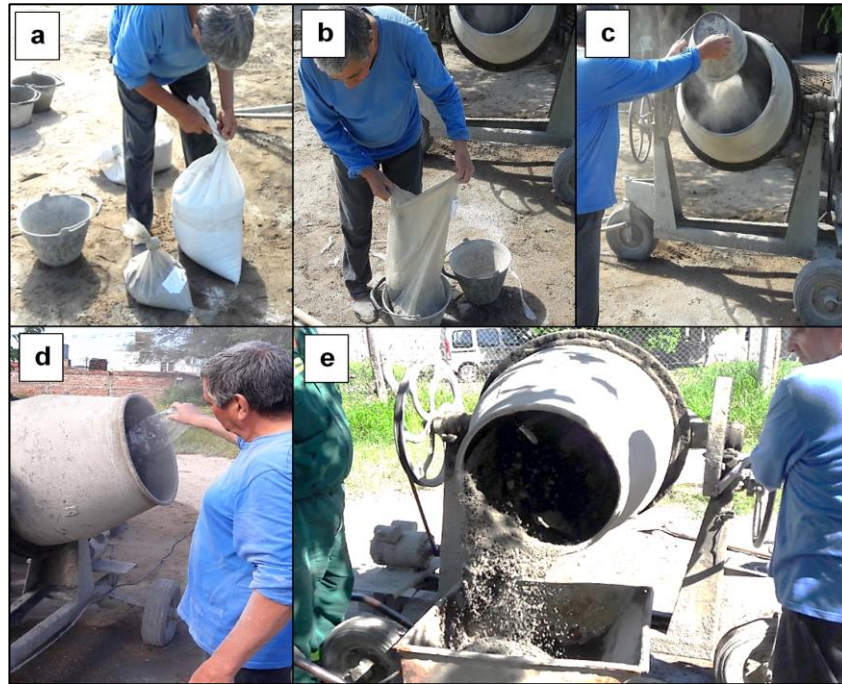
Foto N° 22 – Procedimiento de elaboración de los bloques de hormigón. (a), (b) y (c) Vaciado y trasvase de material hacia la hormigonera. (d) Agregado de agua a la mezcla. (e) Mezcla, homogenización y elaboración del pastón, la cual se vacía en una carretilla metálica para ser trasladada a la maquina bloquera.
