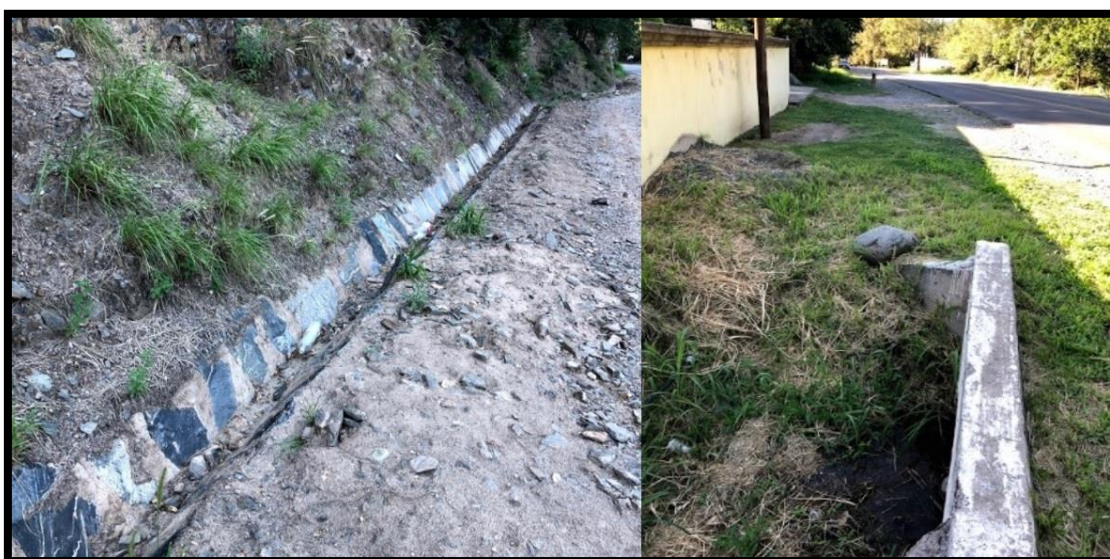
Fotografía 24: Canalización insuficiente y desagüe expuestos a taponamiento por residuos y material de deslizamiento.
