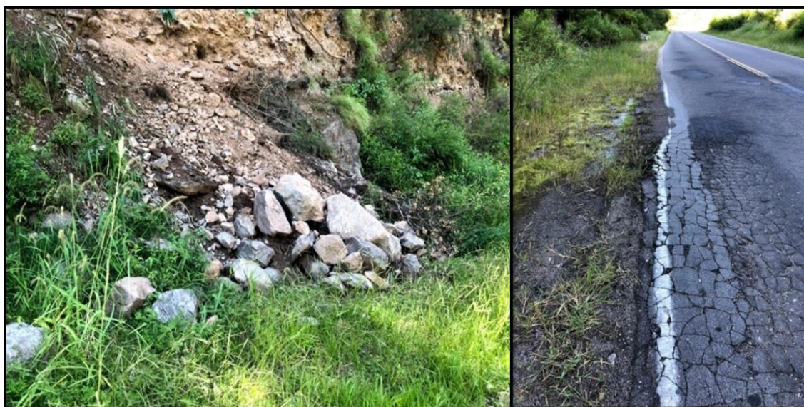
Fotografía 12: Asentamiento de la ruta por filtración.
