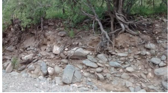
Foto 34: Talud erosionado por cambios, en la morfología del cauce.
