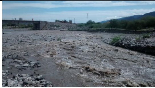
Foto 2: Terraplén Norte erosionado, y cañerías arrastradas por la corriente.
