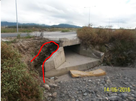
Foto 21: Cárcava en badén de Alcantarilla 2.
