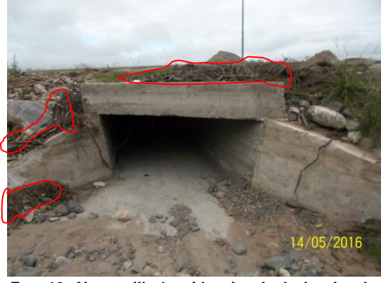
Foto 16: Alcantarilla 1, evidencias de desbordes de flujos no contenidos por la alcantarilla.
