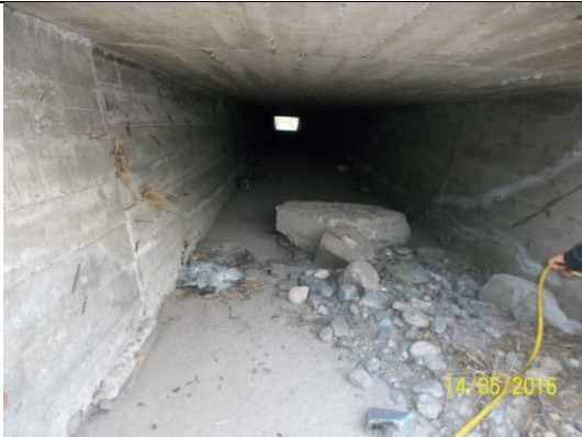
Foto 19: Alcantarilla 2, material obstruyendo.
