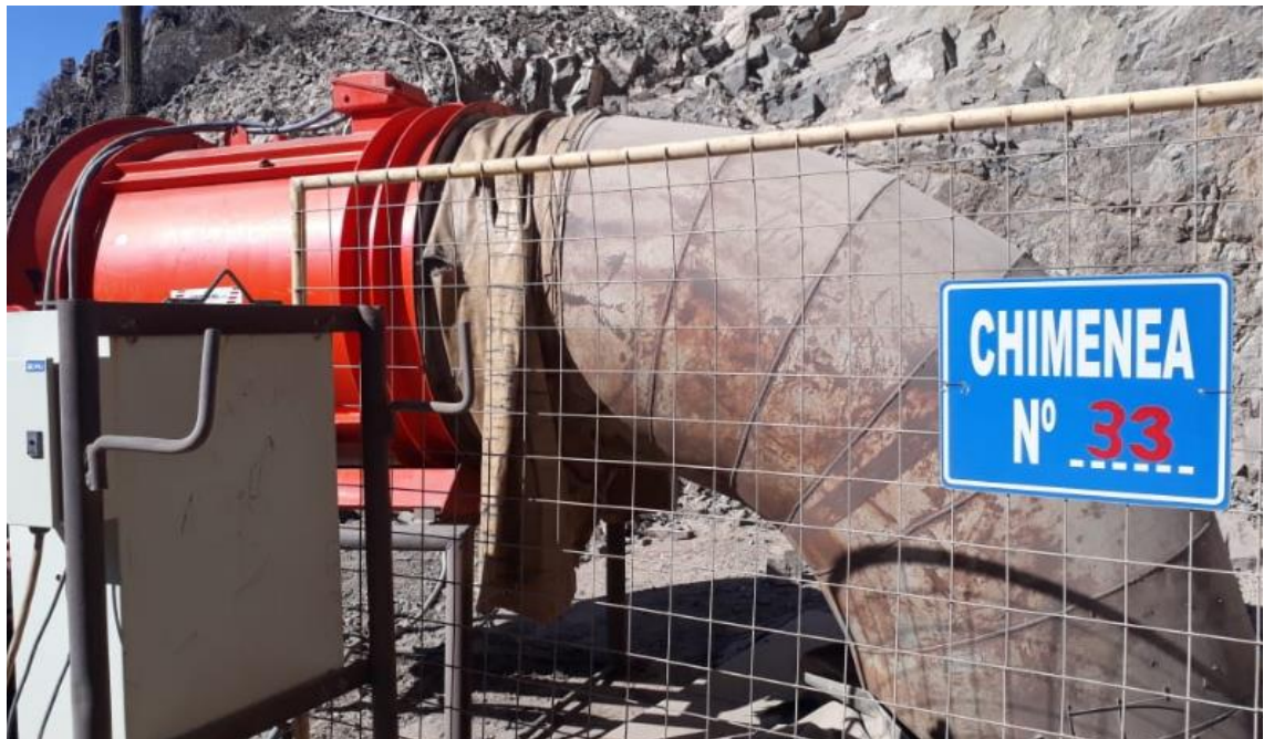
Imagen 9: Chimenea N°33 - Ventilador extractor Cirigliano 54K
