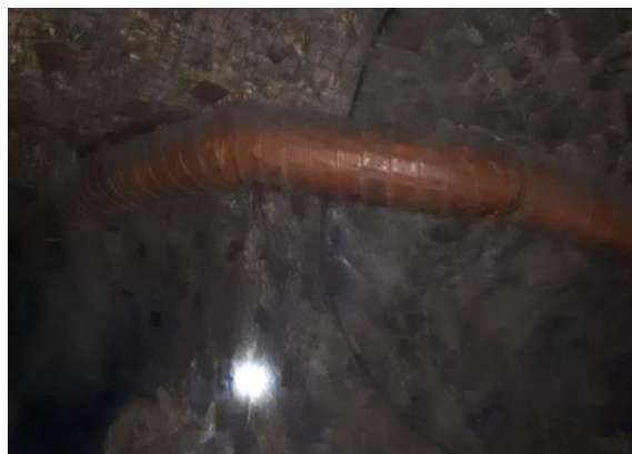
Imagen 20: Tramo de manga corrugada N2515
