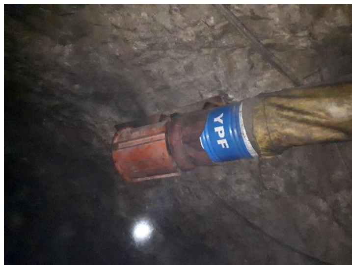
Imagen 19: Ventilador inyector N2552
