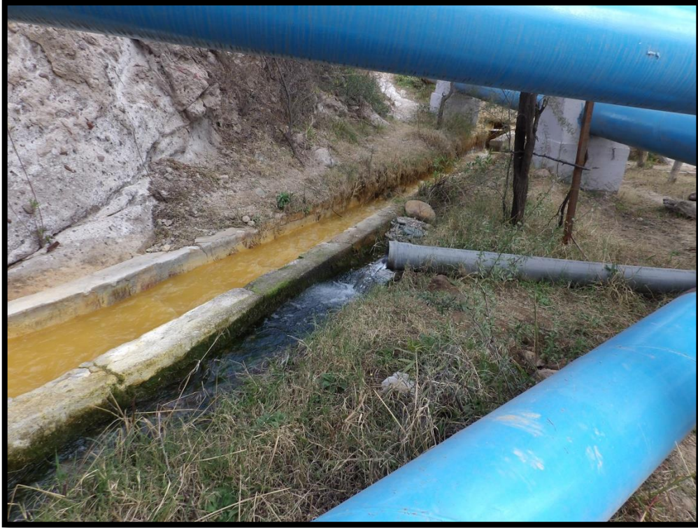
Figura 2.4 Santa Florentina, a 20 metros del Azud del Distrito. Cañerías de conducción de acceso a planta de Agua Potable. Al centro, conducción Canal Matriz para Riego
