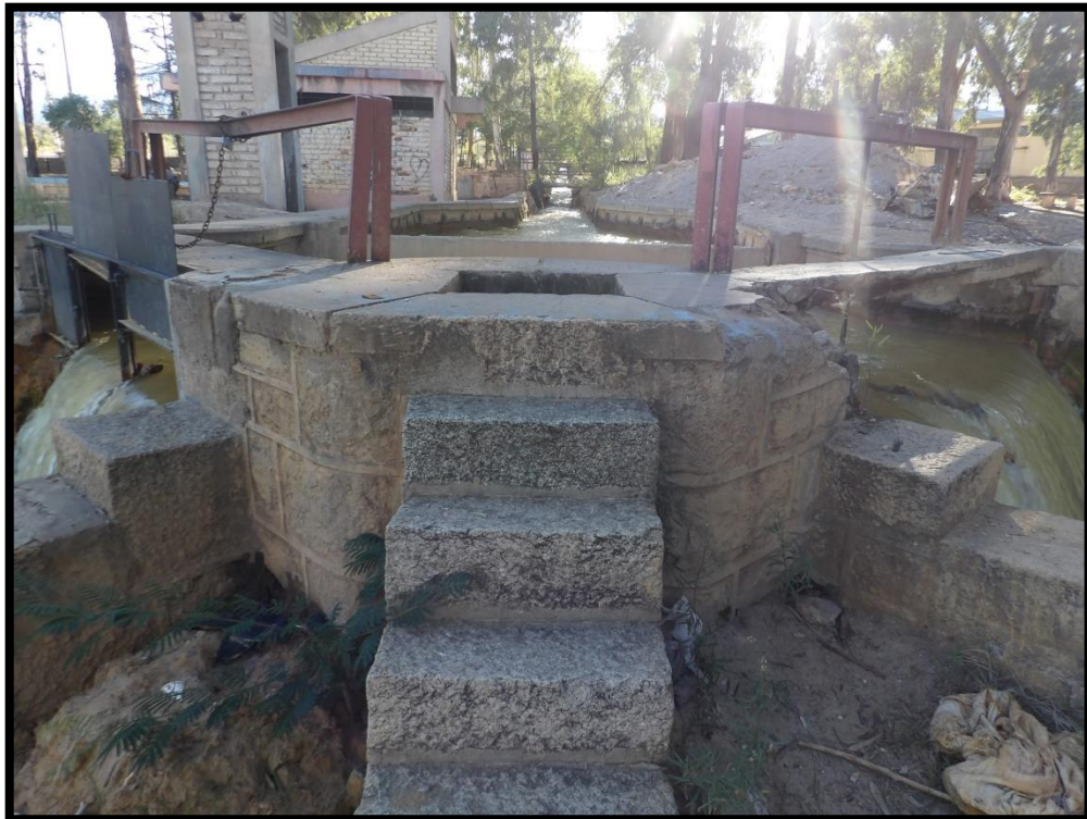
Figura 4.6 Partidor “El Parque”, aguas arriba. Inicio de la distribución secundaria.
