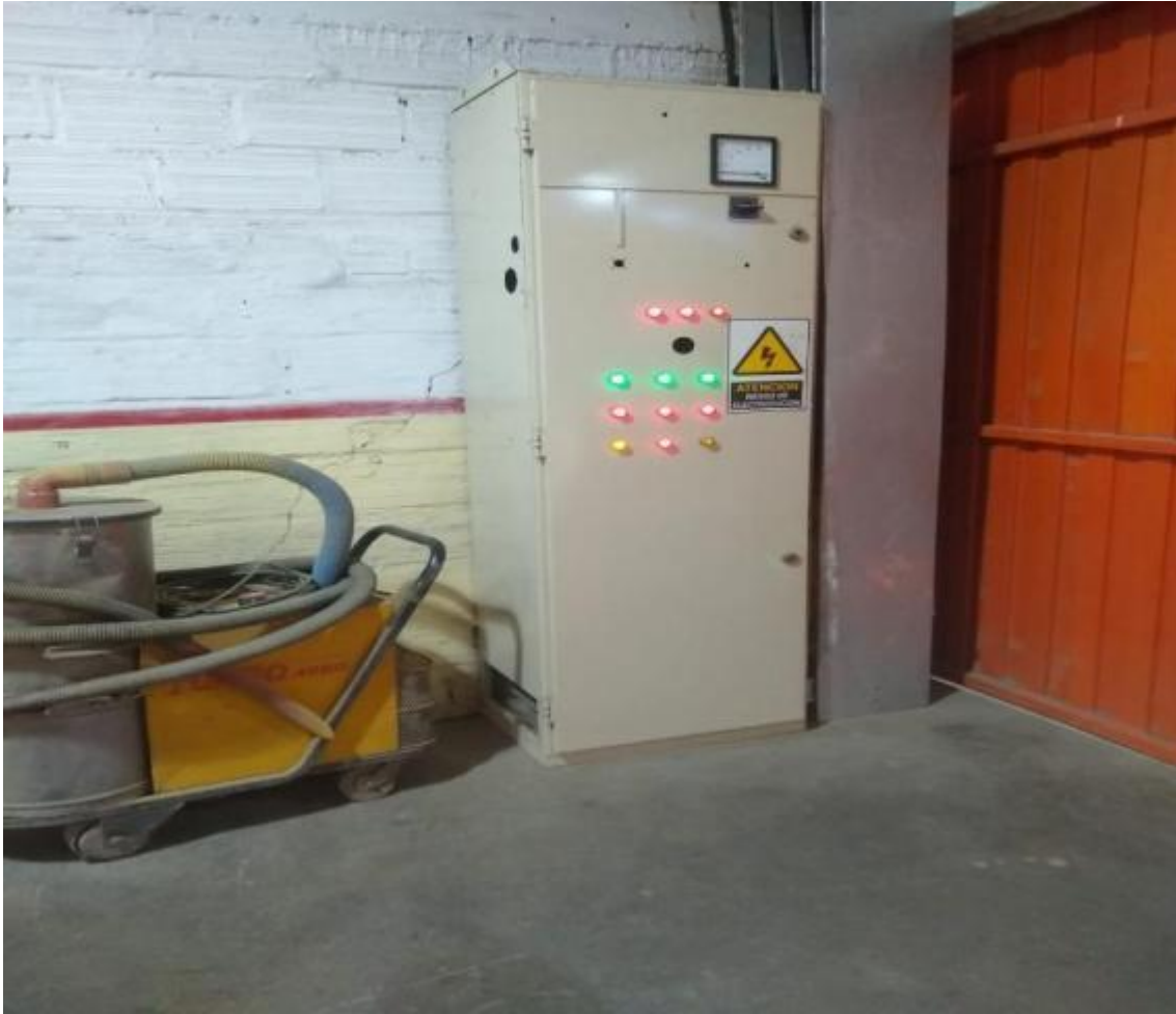
Foto: Tablero secundario
