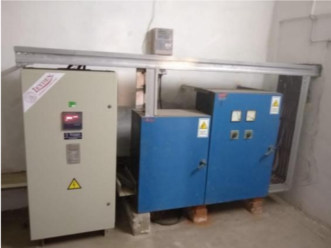
Foto: Tablero principal
