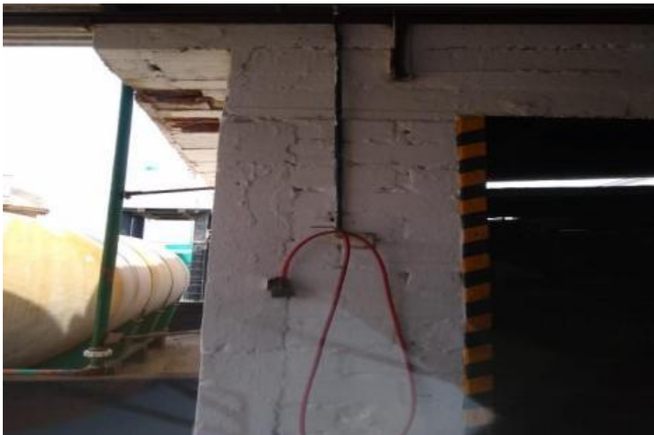
Pistola y cañerías de aire comprimido en el sector de producción “formación”.
