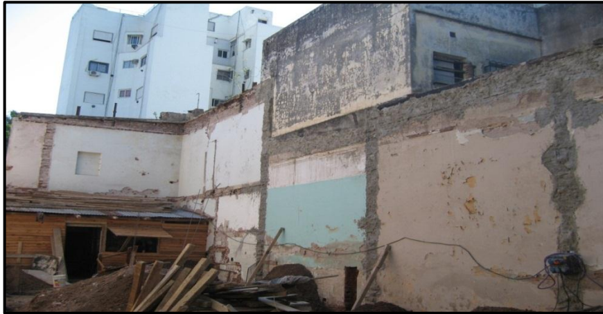
Foto 3.12.2 Pruebas de Medianería: Signos de Medianería
