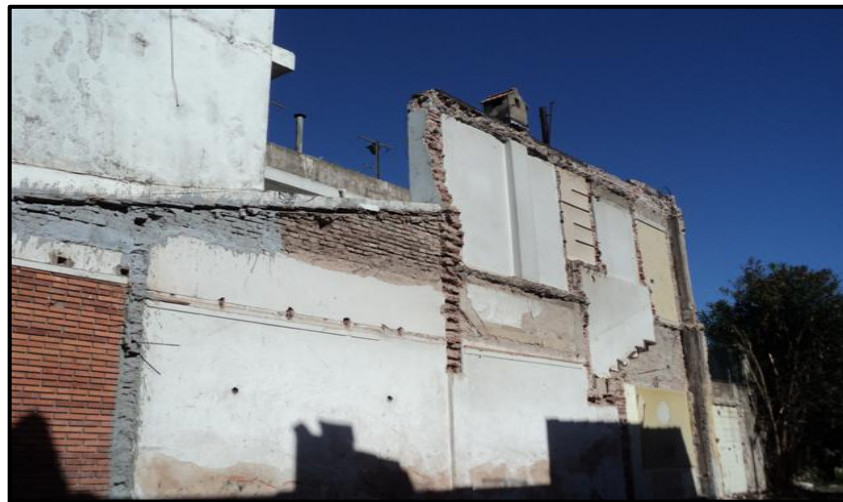
Foto 3.12.3. Pruebas de Medianería: Signos de Medianería
