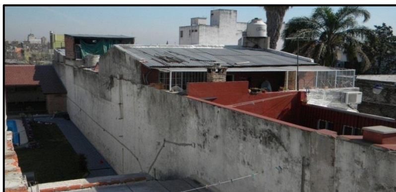
Foto 3.11.1. Muro a Reconstruir
