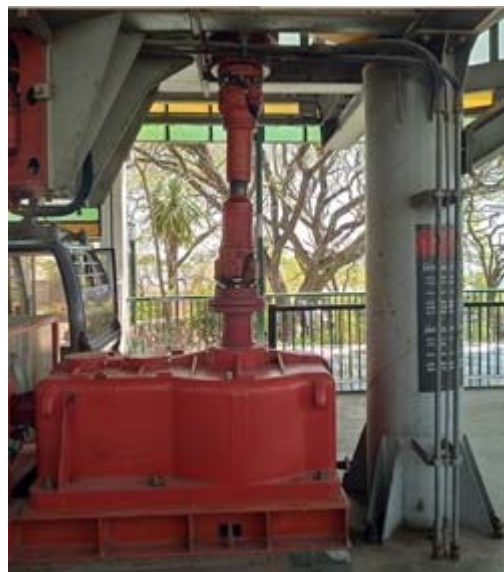
Figura 4- El acople cardánico que se aprecia entre el motor y la rueda motriz principal de un teleférico, compensa los esfuerzos de flexión muy variables que ocurren debido a la variabilidad de la carga en las góndolas
