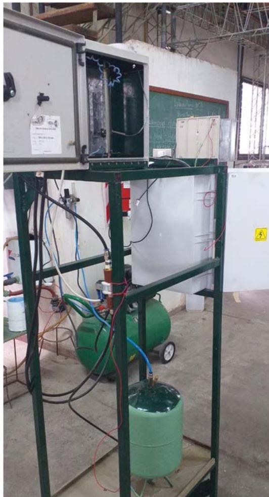
Figura 4. Vista general del equipo.
