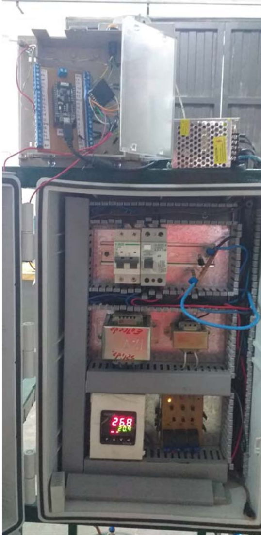
Figura 8. Tablero del SE.
